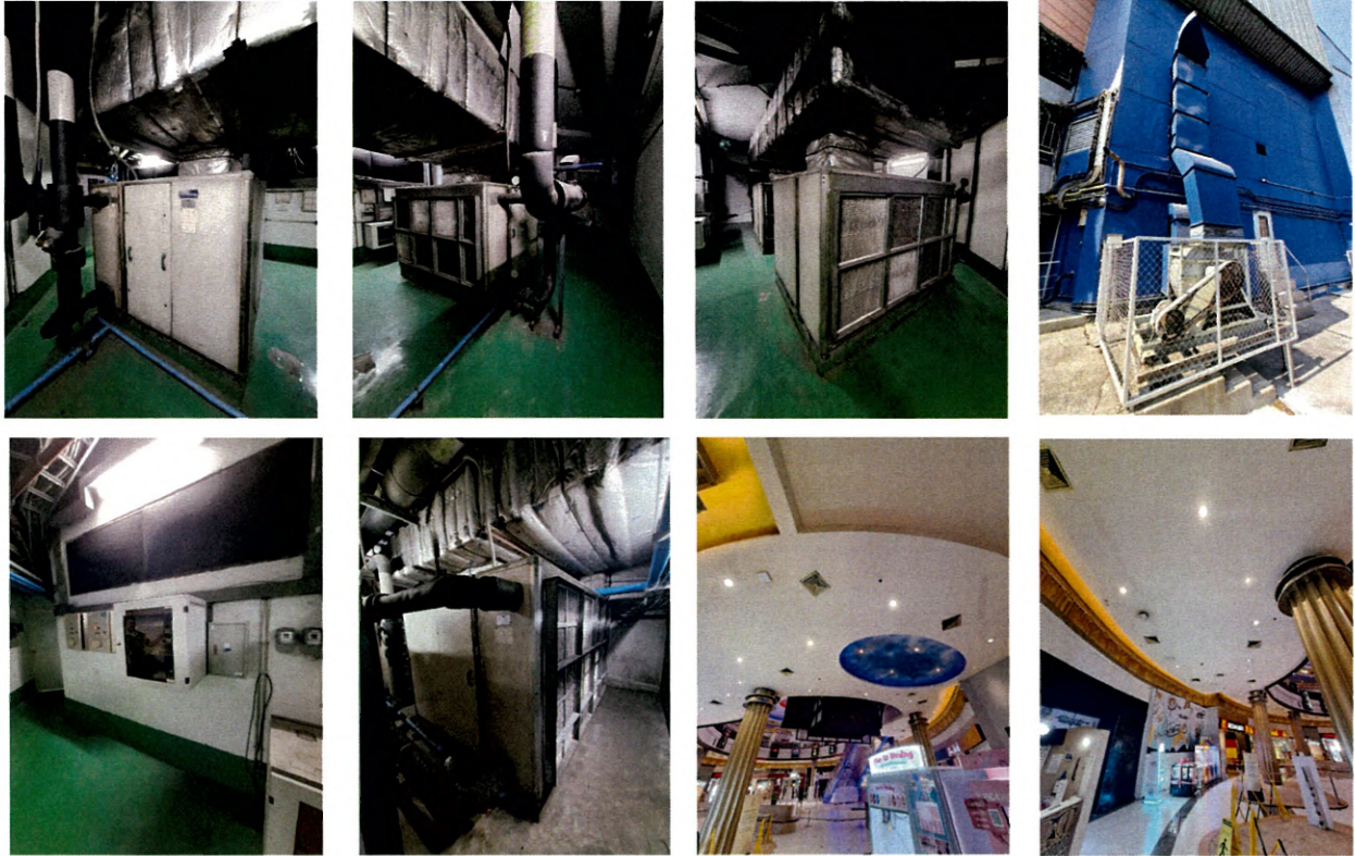
สภาพระบบทำความเย็นอาคาร – เครื่องกรองอากาศ และเครื่องระบายอากาศ
