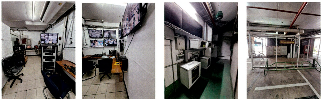
สภาพระบบ CCTV กระจายเสียง และตู้ควบคุมระบบบำบัดน้ำเสีย
