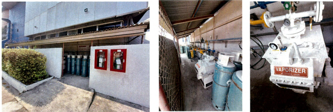
สภาพระบบสถานีแก๊ส LPG – ถังแก๊ส วาล์วต่าง ๆ และหม้อต้มแก๊ส
