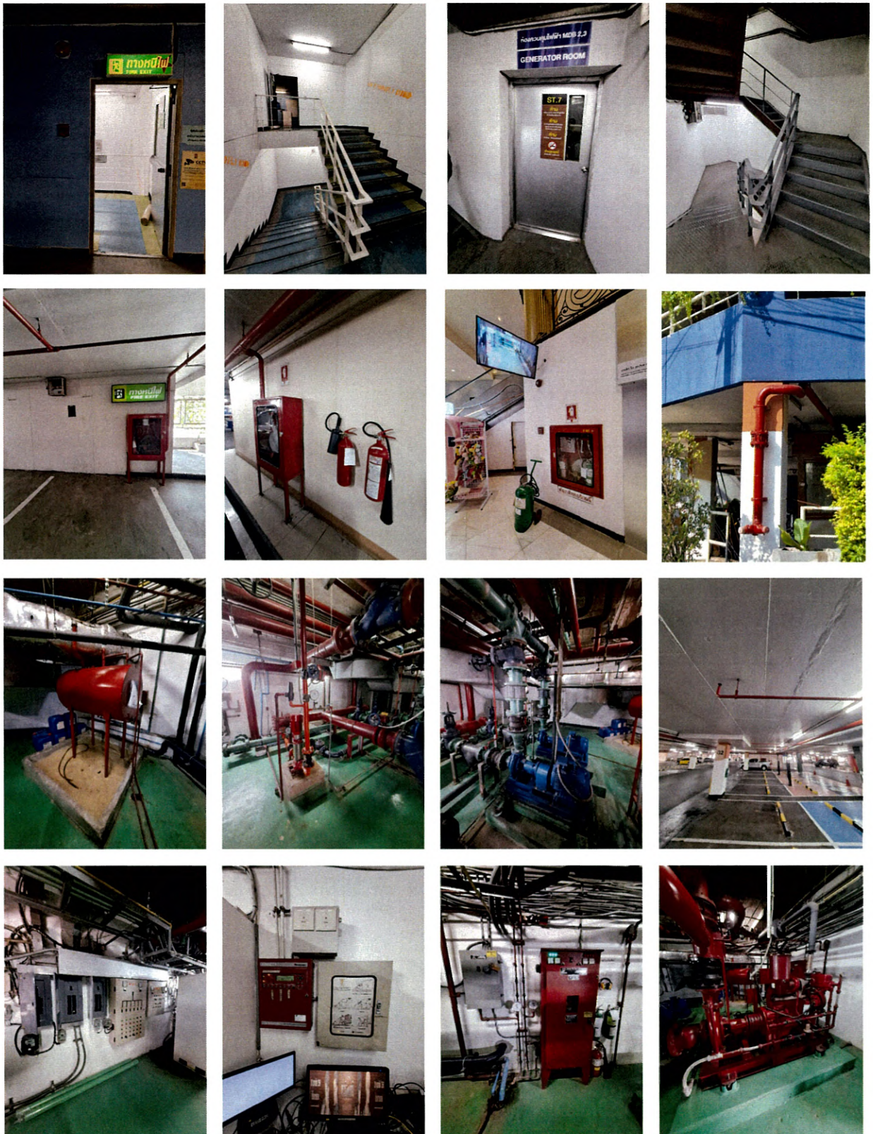
สภาพระบบป้องกันอัคคีภัย - เครื่องสูบน้ำระบบท่อ หัวรับน้ำดับเพลิงอัตโนมัติ สายส่งน้ำดับเพลิง ถังดับเพลิง และบันไดหนีไฟใหม่
