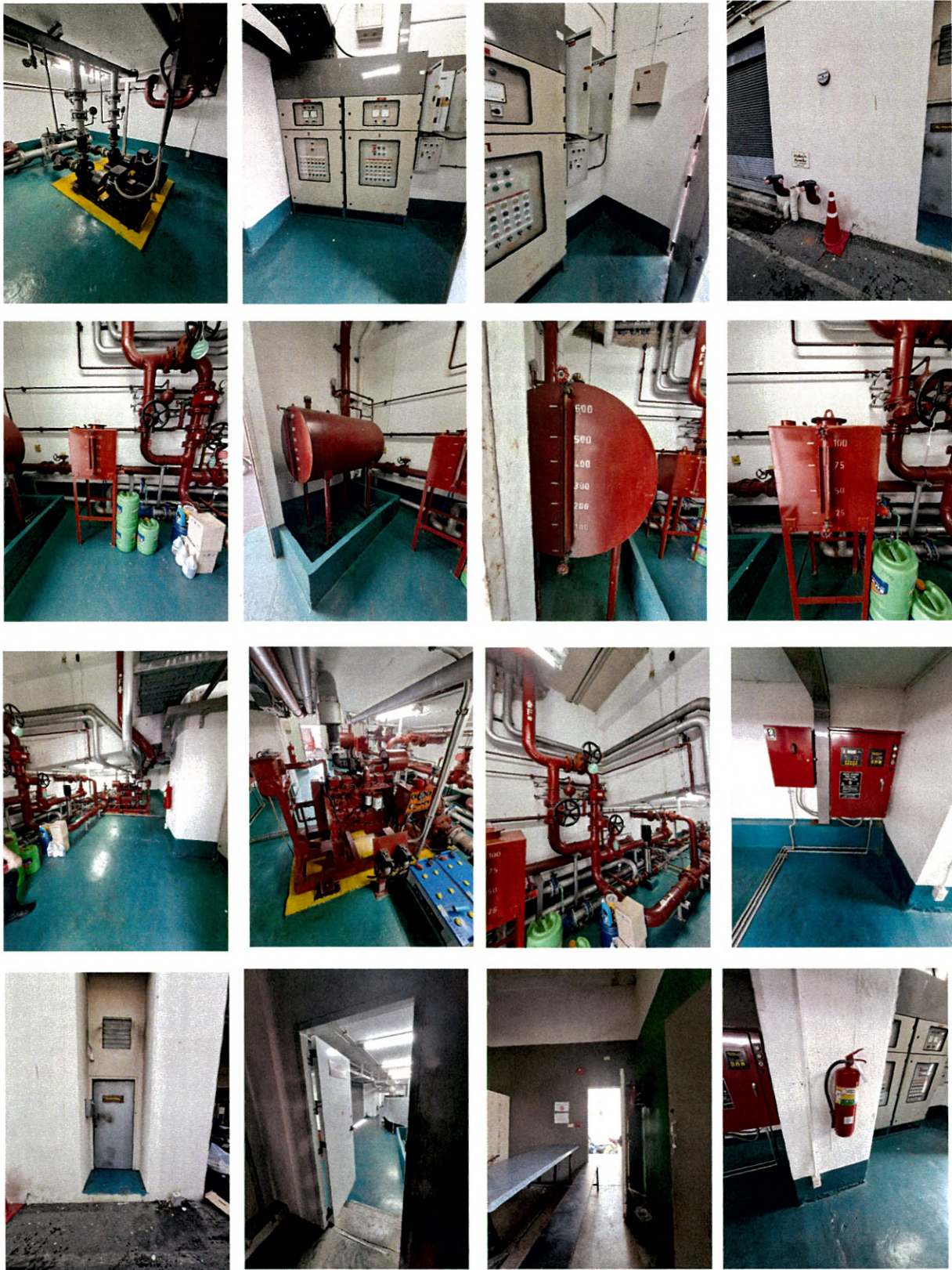
สภาพภายในอาคารชั้นที่ 1 -ห้องเครื่อง ระบบป้องกันอัคคีภัย เครื่องปั้มน้ำสปริงเกอร์ เครื่องสูบน้ำ และตู้ควบคุม
