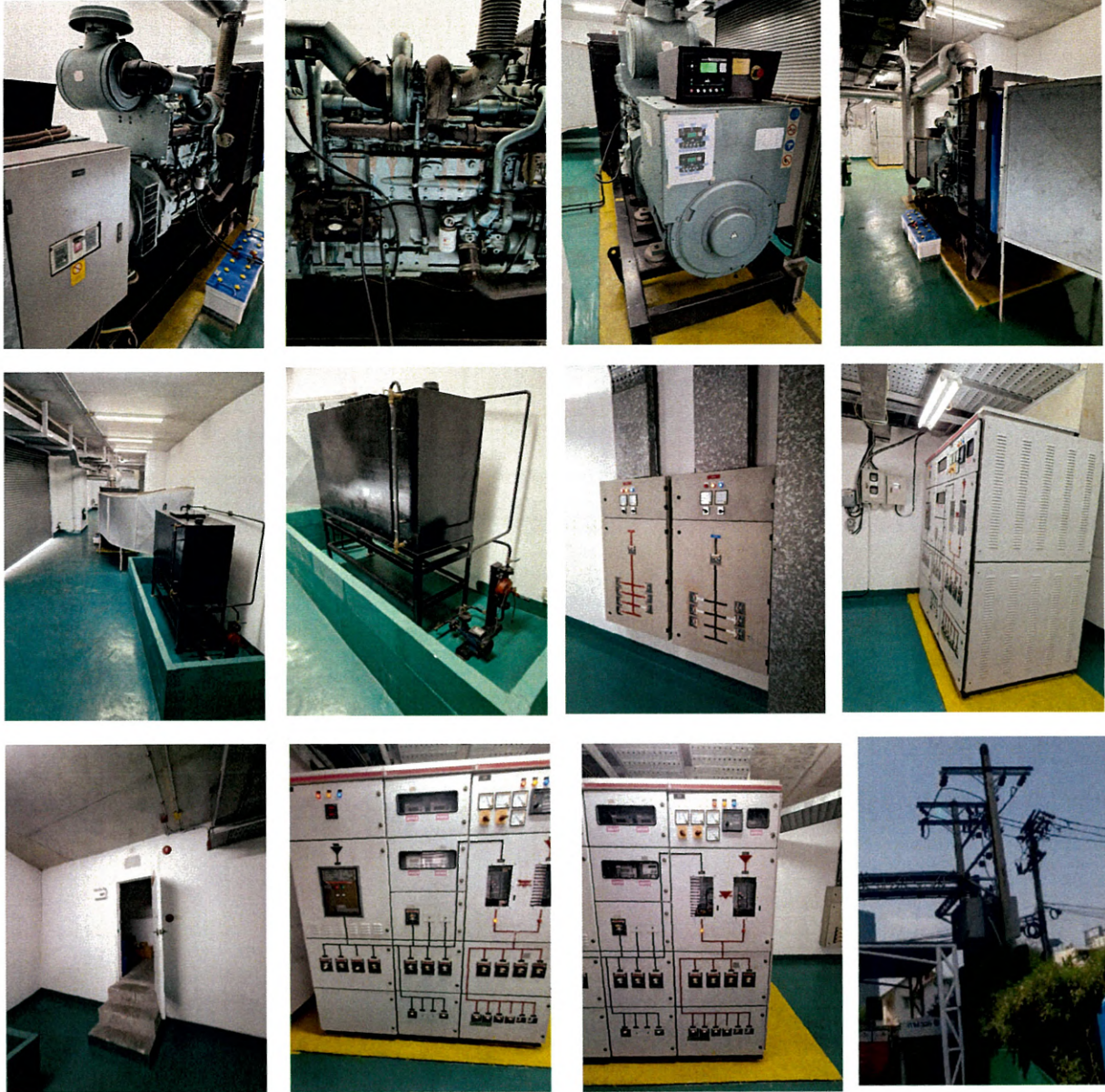
สภาพภายในอาคารชั้นที่ 1 -ห้องเครื่อง ระบบไฟฟ้าฉุกเฉิน ตู้ควบคุมไฟฟ้า และเครื่องผลิตกระแสไฟฟ้า
